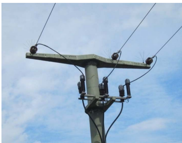
Abb. 2: „Killermast“ bei Haberschlacht, durch den ein Uhu getötet wurde. Die nach unten führenden Kabel sind isoliert und stellen keine Gefahr dar. Im oberen Bereich ist jedoch wie in Abb. 1 die tödliche Kombination mit viel zu kurzen Isolatorn und „Büschelabweisern“ aus leitendem Metall zu erkennen. Letztere sollen zwar als Schutzmaßnahme dienen, allerdings verkürzen sie die Distanz zwischen den leitenden Bauteilen nur und vergrößern somit die Gefahr des Stromschlusses. Möglichkeiten zur Entschärfung dieser Masten bestünden in der Ersetzung der alten Isolatoren durch 60 cm lange Stabisolatoren oder im Anbringen von ebenso langen Kunststoffabdeckungen. Die Büschelabweiser sollten entfernt werden (Foto: J. Fischer).
