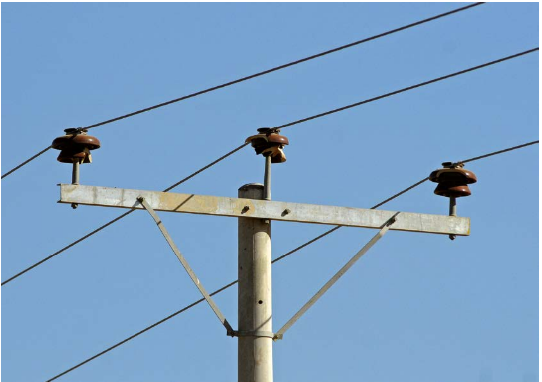
Abb. 5: Beschädigter Killermast: Außer zu Bränden kommt es auch oft zu erheblichen Schäden an den Armaturen. Äthiopien, Dezember 2010. – Damaged insulators of a killer mast. Killer masts often cause woodfires, and their armatures are also frequently damaged by the electrocutions. Ethiopia, December 2010. Foto: D. G. Haas
