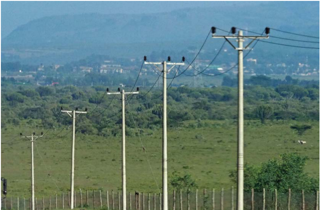
Abb. 34 und 35: Neu errichtete Mittelspannungs-Freileitungen mit Killermasten im vogelreichen Rift-Valley östlich von Nakuru, Kenia, Januar 2020. – Newly-constructed medium-voltage powerlines with killer masts in the bird-rich Rift-Valley east of Nakuru. January 2020, Kenya. Fotos: D. Haas
