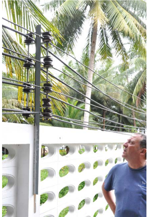
Abb. 27: Gut isolierte Nieder- (vorne) und Mittelspannungsleitung (hinten) im Hotelgarten – gut erreichbar, aber völlig ungefährlich für Hotelgäste wie Richard SCHNEIDER (abgebildet). 26.10.2013 Thailand. – Well insulated conductors of a low-voltage- (foreground) and a medium-voltage powerline (background) in the garden of our hotel. They are easily reachable, but completely safe for the guests. Richard SCHNEIDER (in photo). 26.10.2013 Thailand.
